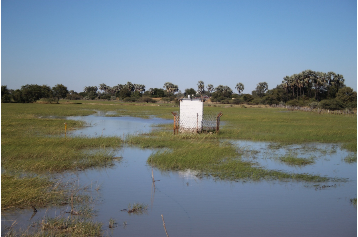
Figure 14: O Sistema de Alerta Prévio existente e não funcional no local proposto de Oshana – Shanalumono, na aldeia de Ohaingu (Créditos da foto: autores 2025).
